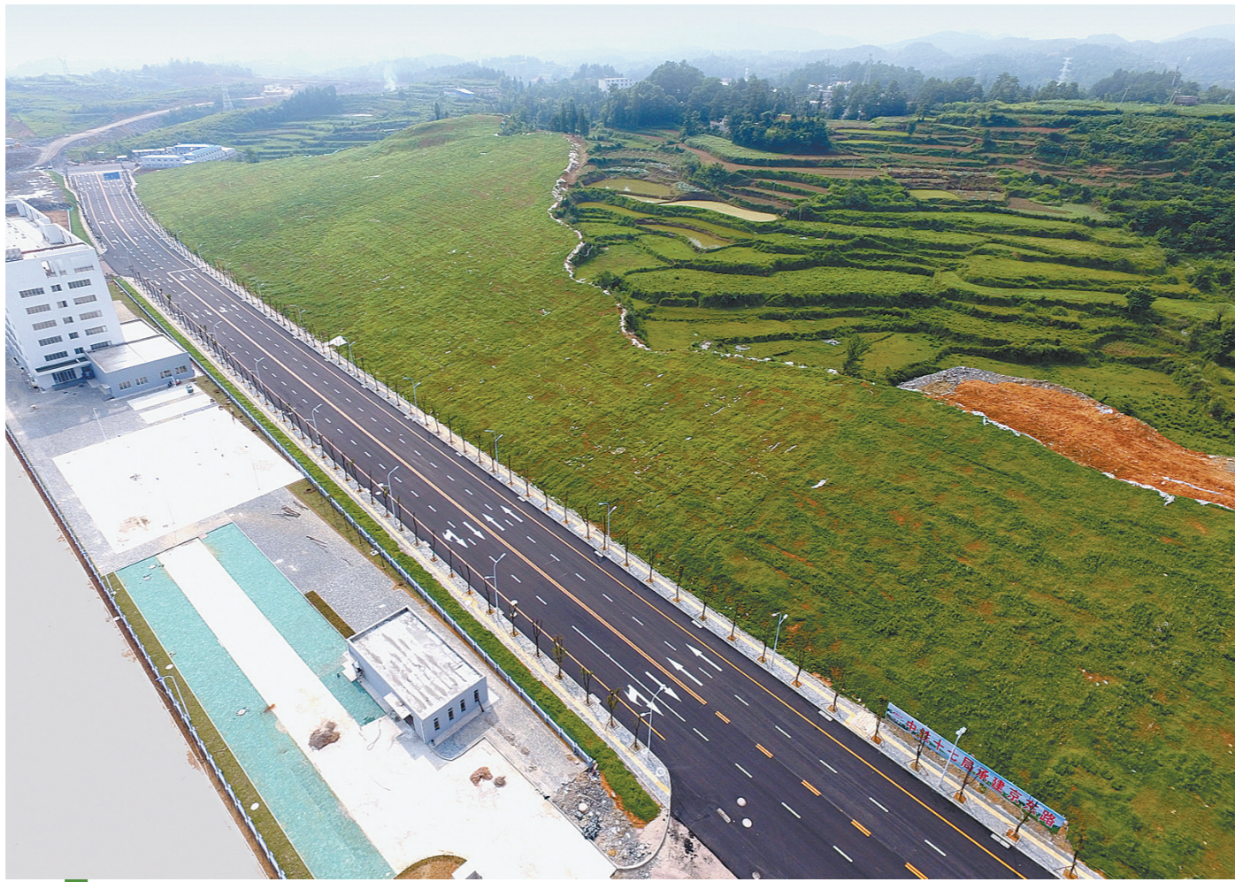
中铁十七局一公司承建的贵阳市观山湖京东路项目,穿越绿色农田。为保护自然环境和农业生态,项目部制定专项环境保护方案,并采用科学的爆破方法进行石方开挖,没有给农田带来污染,受到当地老百姓称赞。张栋摄
