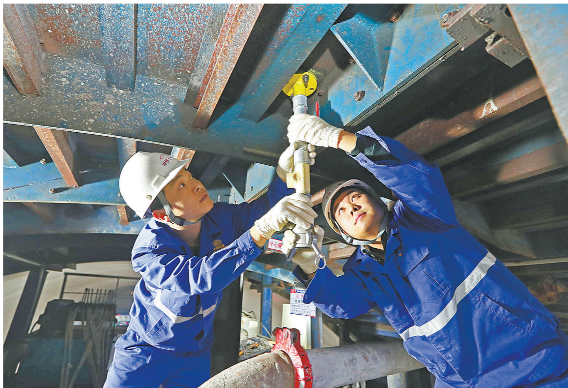
中铁十一局在京沈客专隧道施工中,为确保证施工质量,成功研发了隧道二次衬砌拱顶带模注浆成套施工技术,有效保证了隧道衬砌质量。图为施工人员在安装注浆管连接条件。 本报记者 徐云华摄
