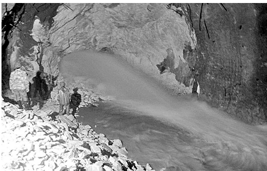
辅引3号施工支洞强涌水
