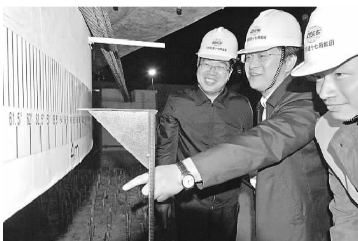
十七局集团副总经理兼总工程师杜嘉俊(左一)和四公司执行董事、总经理王应权(中)在观察旋转刻度盘变化。
