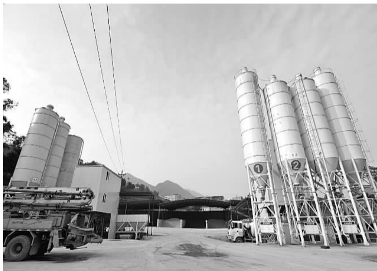
规范整洁大气的混凝土拌和站
