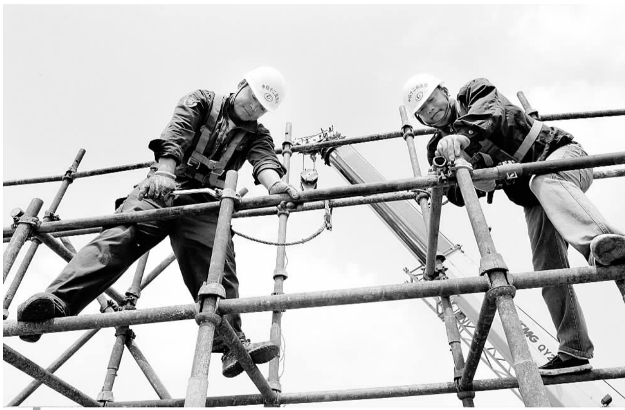
十二局集团一公司在东北新建沈西工业走廊火石岗至渤海铁路工程施工中,针对高空作业风险大的特点,要求职工“安全警钟要常鸣,三检一刻不放松”,确保施工生产稳步推进。图为职工正在立脚手架。本报记者 武羽 摄
