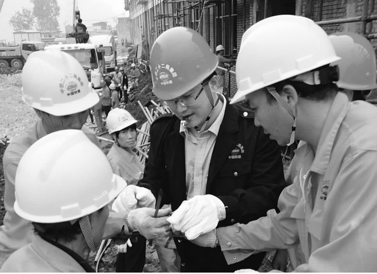
二十二局集团电气化公司贵州茅台酒改扩建工程项目部面对电力施工中存在触电和登高危险,狠抓员工安全培训,制定了一套合理完善的安全预防管理体系。图为项目书记李春城向现场施工人员讲解电缆注意事项。郭红 摄
