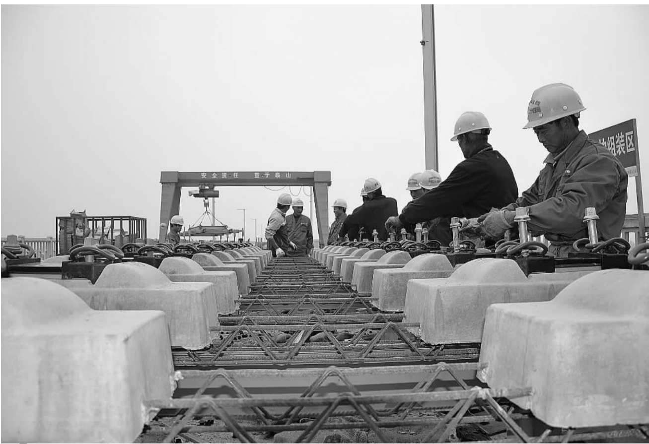
目前,由二十四局集团施工的合福铁路安徽段站前四标正在开展大于4个月劳动竞赛活动。业主在二十四局集团五分部连续召开高速道岔、无砟轨道、站房施工观摩会,对其施工水平给予高度评价。因为在漳河特大桥无砟轨道施工中,五分部安徽公司参建员工在认真组装扣件。 王运亮 摄
