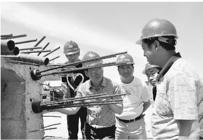
十七局集团五公司管双项目部把质量工作放在首位,严格按照施工规范和验收标准进行施工,做好质量控制关键点的管理工作,落实质量责任,开展质量控制关键点QC小组活动,做到施工程序化、工艺标准化、操作规范化,赢得了业主和监理单位的广泛好评。图为项目部在进行每月一次的质量职责制的落实情况检查。 郭 靖 摄
