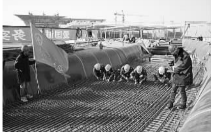
十八局集团五公司滨海站项目部青年突击队在绑扎钢筋。
