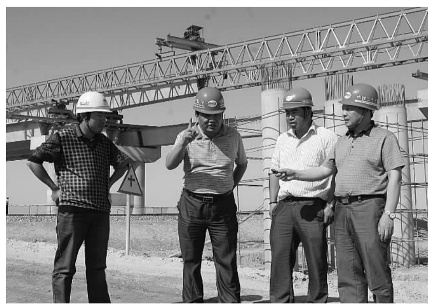
二十三局集团三公司三莎项目经理杨焕科(左二)在工地检查指导工作。
