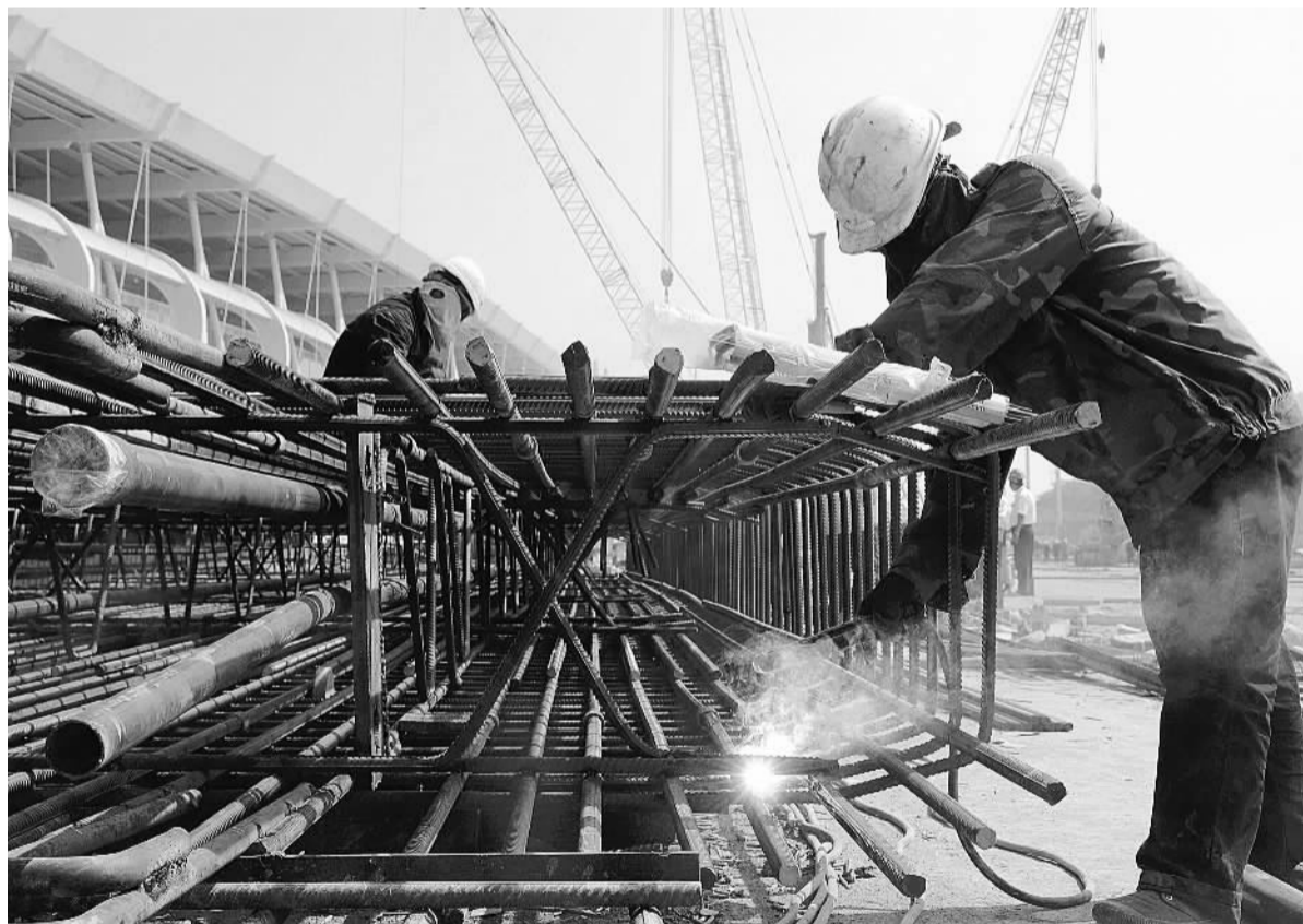
十八局集团一公司承建的港珠澳大桥珠海连接线拱北隧道是港珠澳大桥的主要组成部分。该合同段东、西工作区连续墙施工场地狭小、地质条件差。施工中,项目部严格控制钢筋笼加工质量,合理选择吊装设备,采用“整体制作、整体吊装、一次性入槽”的方法,顺利完成了多幅连续墙施工。图为员工焊接作业。
