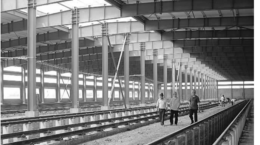
由十五局集团六公司承建的天津地铁曹庄列检库主体工程于日前完工。这座轻型门式钢架结构列检库面积为8854.5平方米,可同时容纳10台地铁列车的存放、检修。图为设有10股轨道的曹庄列检库大厅。丛建伟 摄
