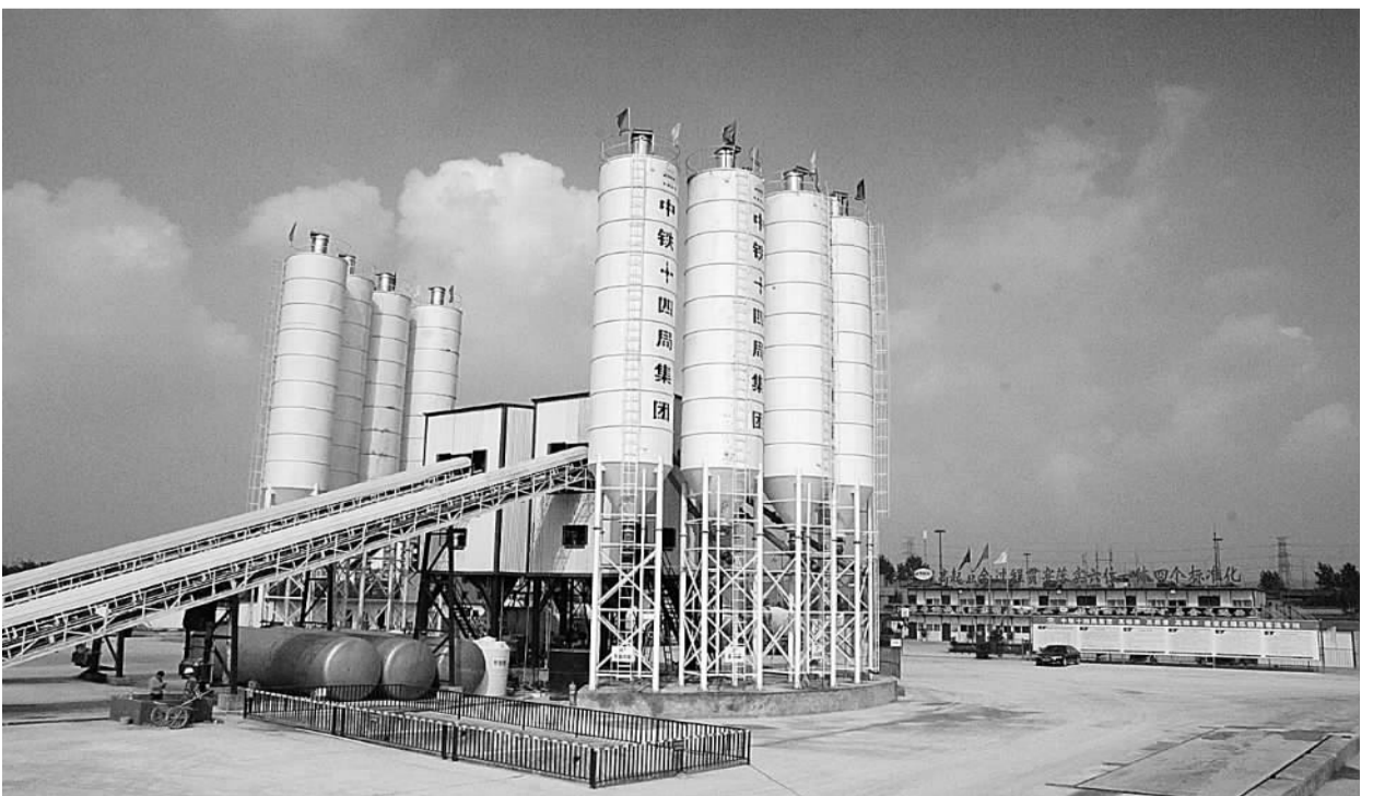
十四局集团一公司气势宏伟的3号拌和站
