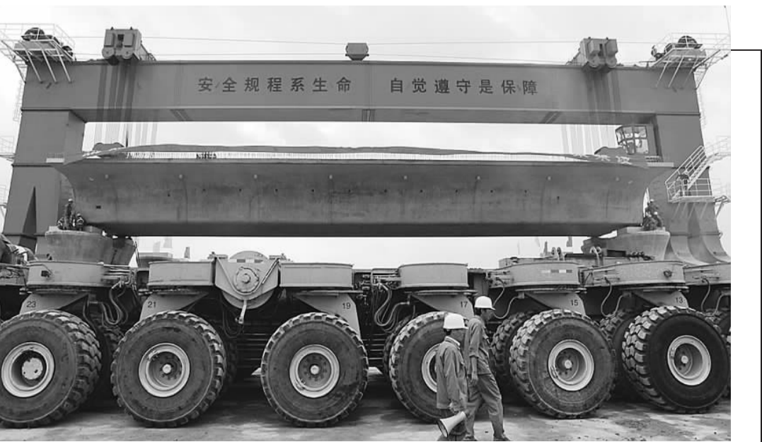
近日，由二十二局集团承建的湘桂铁路扩改工程柳南段和南黎铁路工程 III 标横寨大桥架梁现场，一片长 32 米、重达 900 吨的混凝土箱梁，稳稳安放在墩台上，宣告湘桂铁路全线首片架梁成功。赖迪 摄
