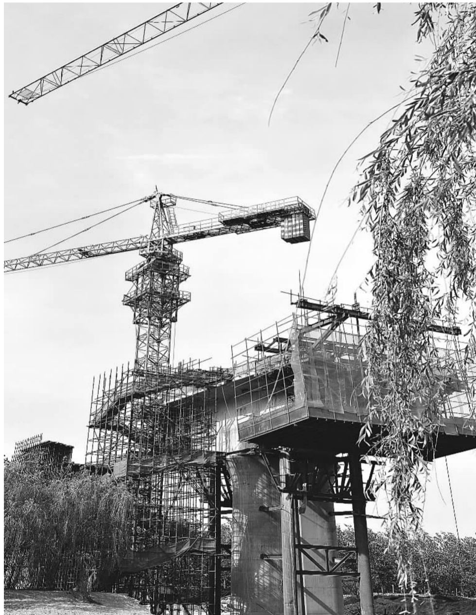
全长 10 公里的京石铁路客运专线涿州特大桥，沿途多处跨越铁路、公路、河道，悬灌现浇梁和转体连续梁多，是全线重难点工程之一。十二局集团三公司在施工中注重发挥科技优势，攻克了多项技术难关。图为跨石太高速公路悬臂连续梁施工现场。冯学亮 郭买生 摄
