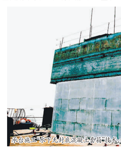
承台施工“水下无封底混凝土套箱”技术,被评为山东省科技进步一等奖,并申报国家专利
